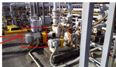
工場設備の写真
